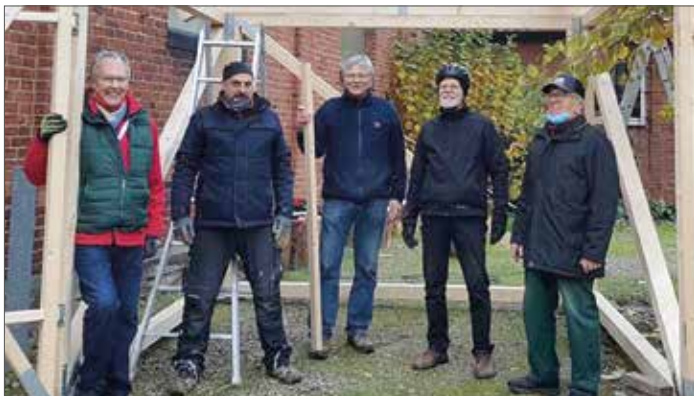
Das Bauteam beginnt mit dem Stallbau: Klaus Kullig, Christian Levers, Wolfgang Rehkate, Lutz Bersiner sind Heinz Flörke (von links). Auf dem Foto fehlen Klaus Hartmann und Stephan Rehlich.
